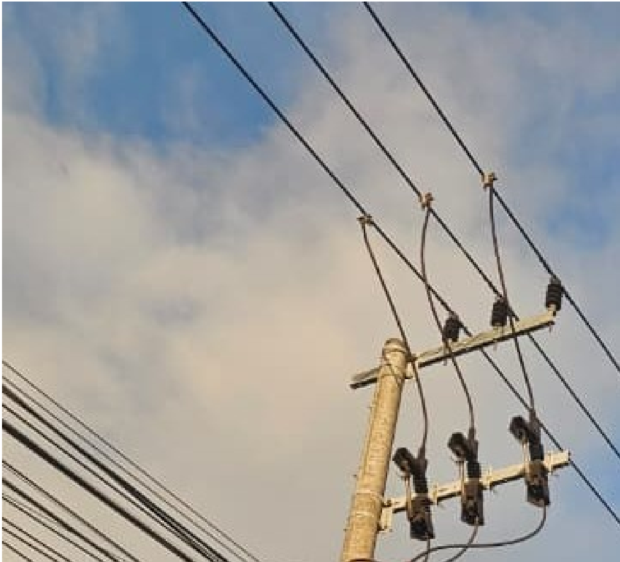
GAMBAR 3 PENGGUNAAN TEKEP ISOLATOR PADA FUSE CUT OUT PERCABANGAN/SECTION
